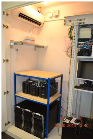
Ansicht Server-Schrank mit USV-Anlagen
